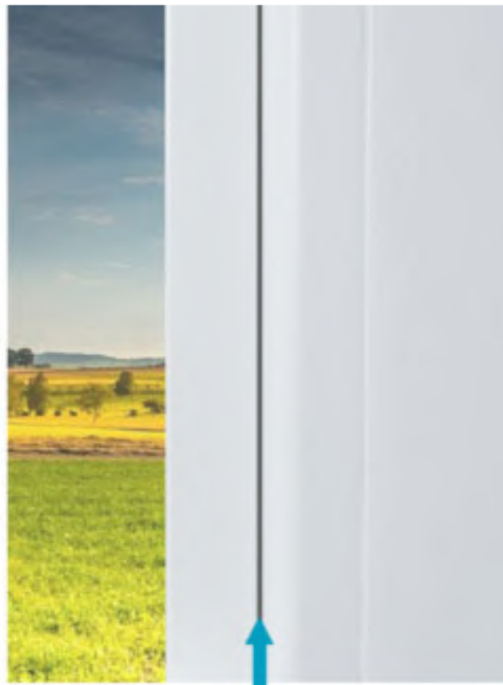
Dichtungsbreite über 5mm Klebeleiste überdeckt NICHT komplett die Dichtung
